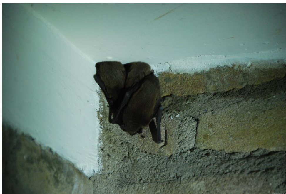
Vleermuizen in het gebouw aan de Sprengparklaan te Apeldoorn (foto: Ruud Kaal)
